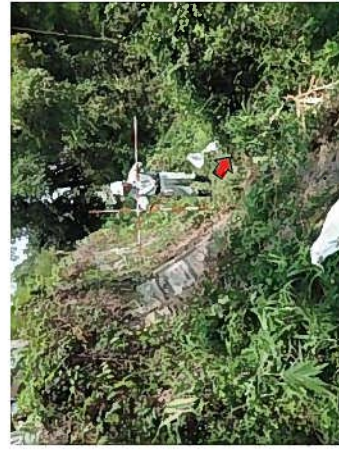
ブロック積み擁壁(滑動)
