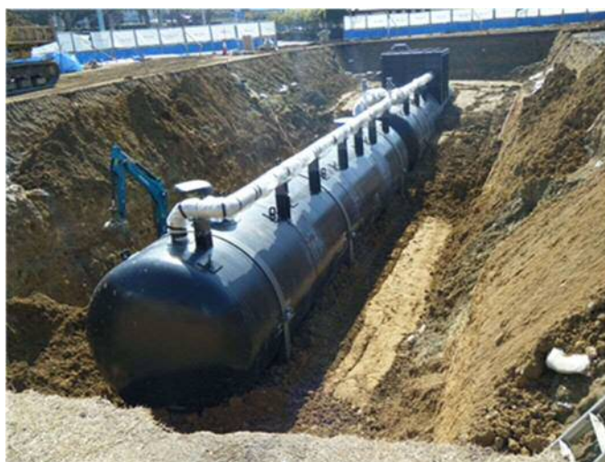
社中央公園（緊急用貯水槽 200m 3 ）
