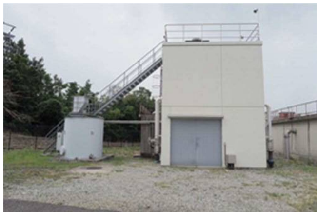
粉末活性炭混和設備
