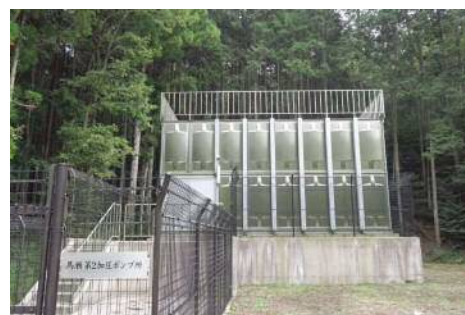
馬瀬第 2 加圧ポンプ所
