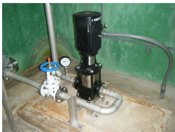
平木加圧ポンプ所のポンプ設備
