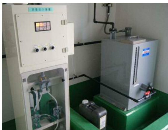
追加塩素設備（湖翠苑加圧ポンプ所）
