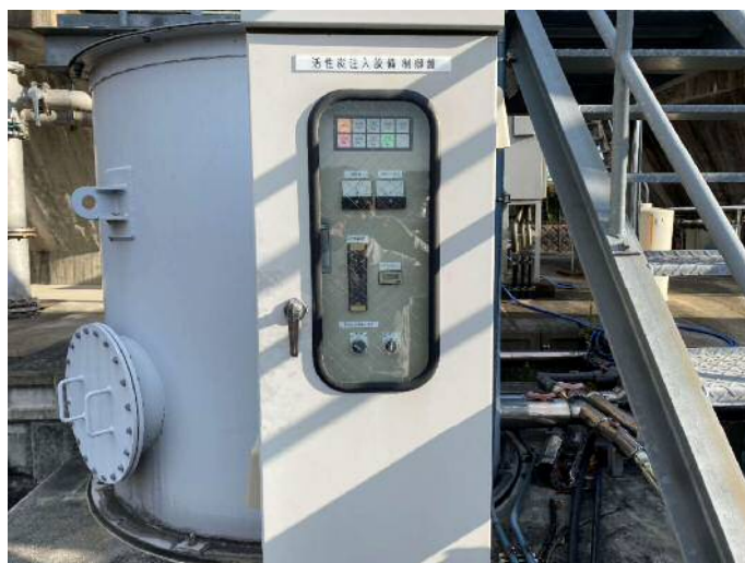
活性炭注入設備
