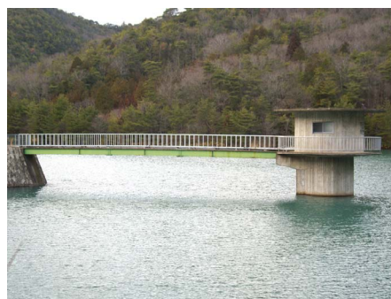
上鴨川取水場（オノ神池）
