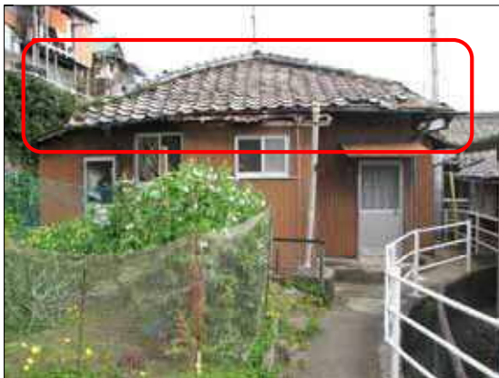
屋根に不陸がある例
