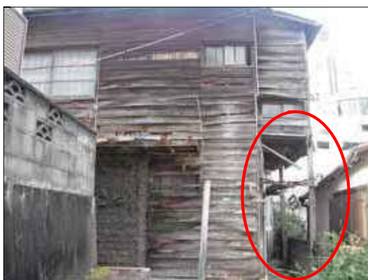
柱の数箇所に破損がある例
