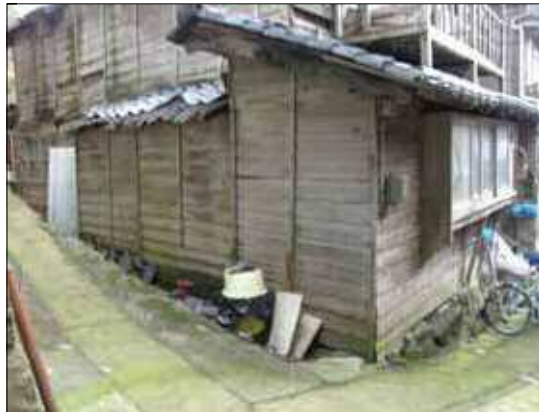
外壁が裸木造の例
