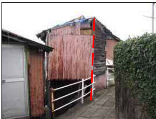
一部の柱が傾斜している例
