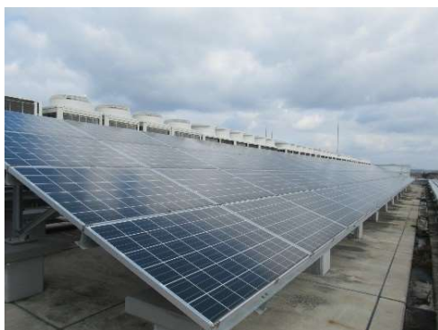
庁舎に設置された太陽光パネル
