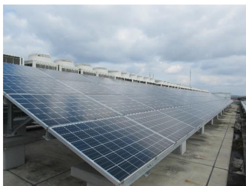
庁舎に設置された太陽光パネル
