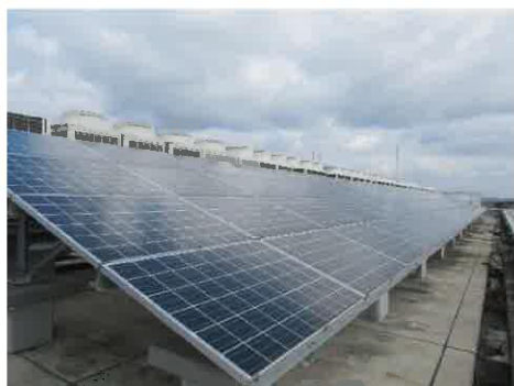
庁舎に設置された太陽光パネル
