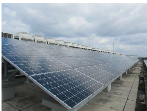
庁舎に設置された太陽光パネル
