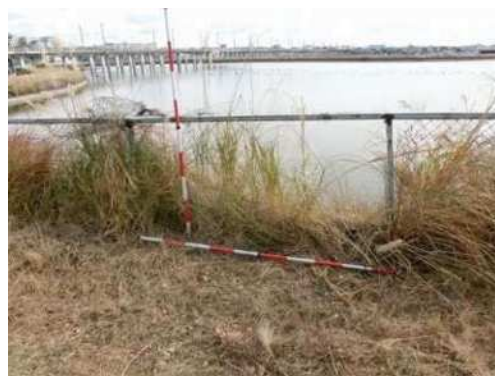
柵の破損 (網が破れていないか確認しましょう)
