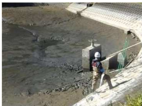
泥土堆積状況(かいぼり実施前)
