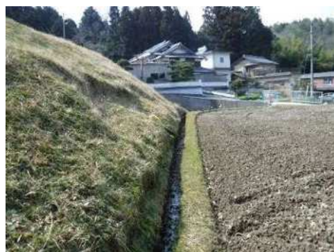
後法 はらみだし及び陥没
