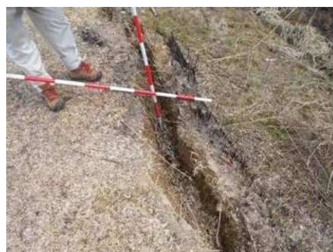
堤頂 ひび割れ
