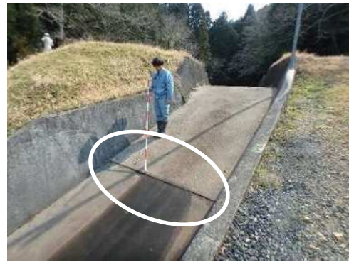
放水路部 漏水
