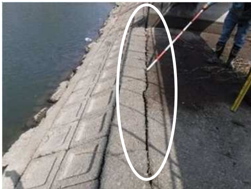
洪水吐流入部 ひび割れ
