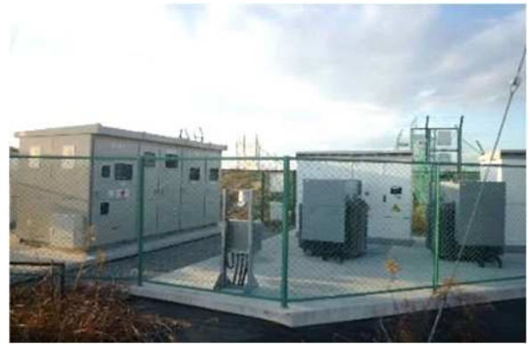
変電設備における侵入防止柵
