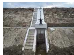
取水施設(底樋)
