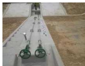
取水施設(斜樋)
