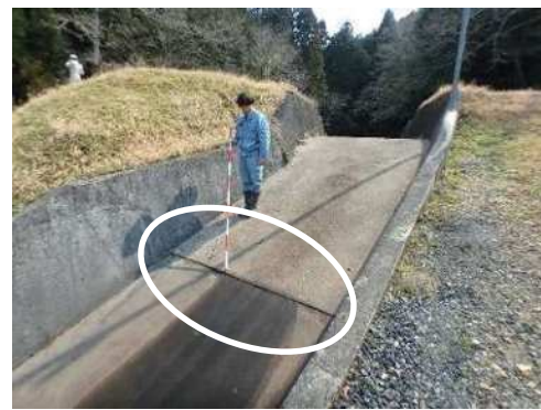
放水路部 漏水
