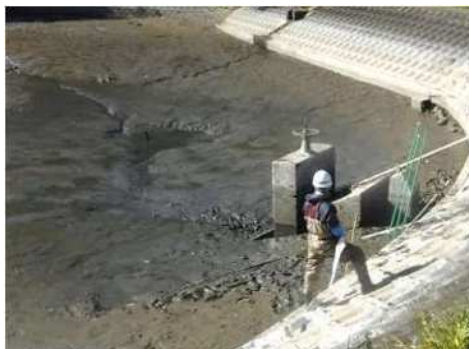
泥土堆積状況(かいぼり実施前)
