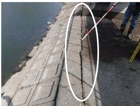
洪水吐流入部 ひび割れ
