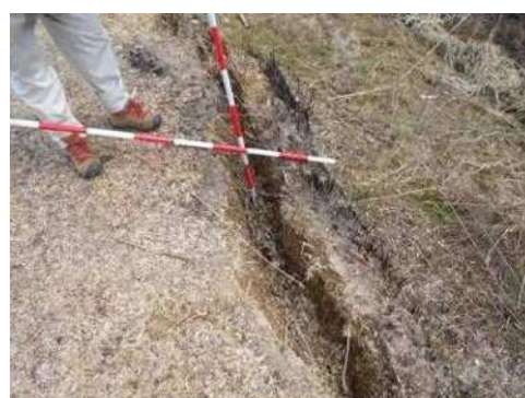
堤頂 ひび割れ
