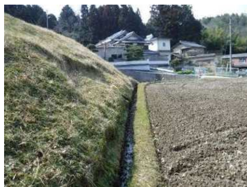
後法 はらみだし及び陥没
