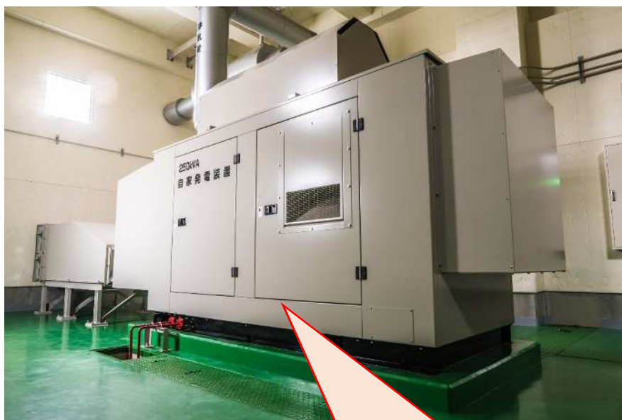
非常用ディーゼル発電機 250kVA 1台
