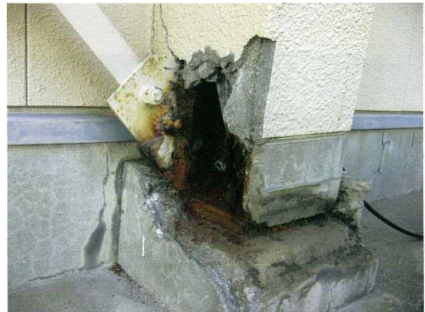
↑ 重度のさびの例（腐食度 0.0 程度）
