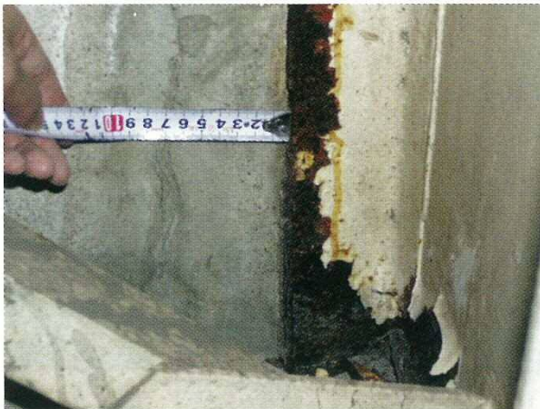
↑ 中程度のさびの例（腐食度 0.5 程度）
