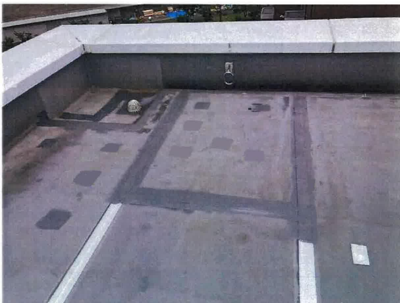
雨漏り状況 屋上床スラブ ドレン 1箇所
