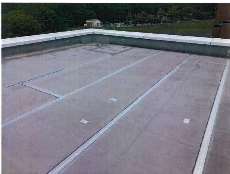
雨漏り状況 屋上床スラブ 防水補修 18箇所
