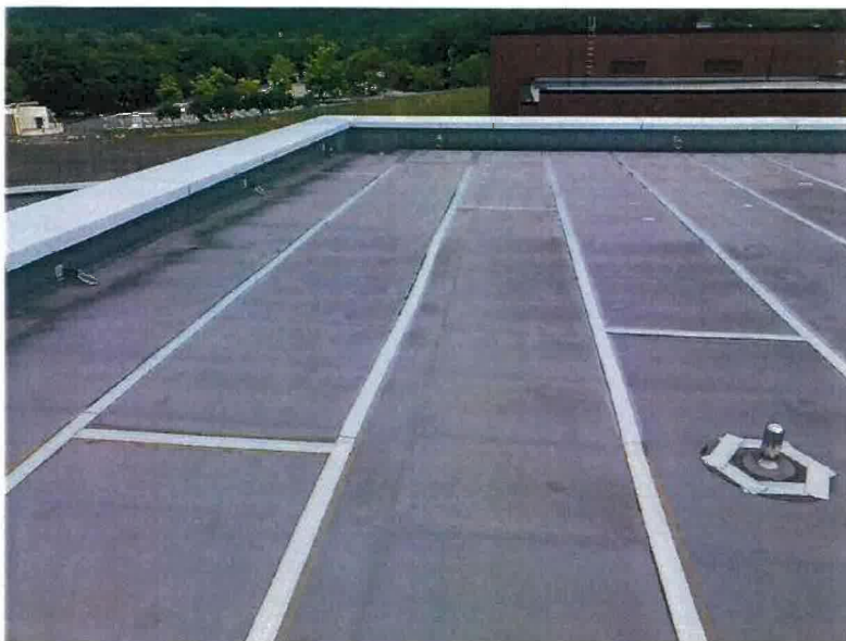
雨漏り状況 屋上床スラブ 防水継ぎ目 L=43.5m 脱気筒 1箇所
