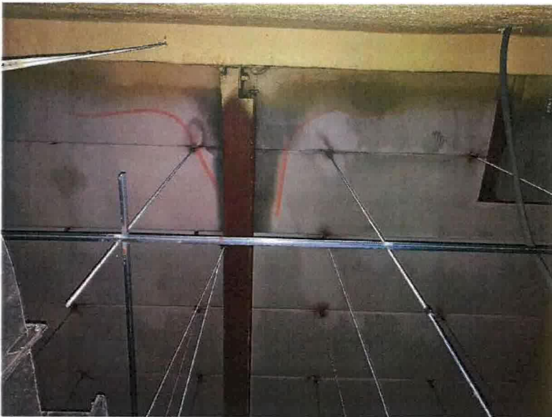
雨漏り状況 3階 研修室 天井 雨漏り部分確認
