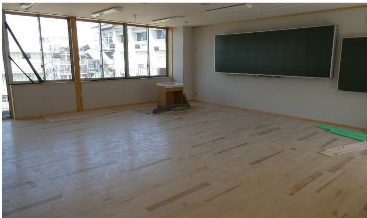
増築校舎棟3階 特別支援教室内装工事状況（令和6年3月15日撮影）
