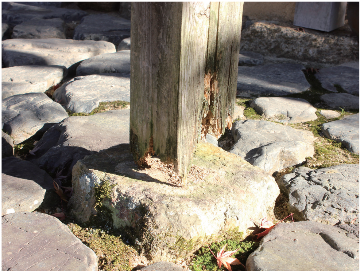
三草藩武家屋敷旧尾崎家中庭井戸の屋根材腐朽状況
