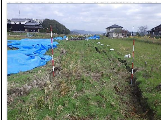
⑯. 地すべりブロック冠頭部 圃場
