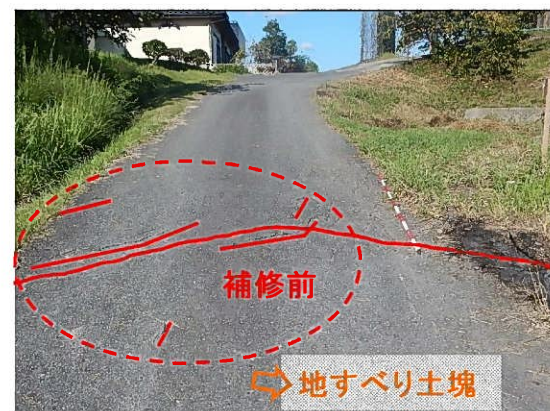
⑬. 右側側部 舗装クラック
