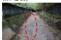
底版横断方向ひび割れ
