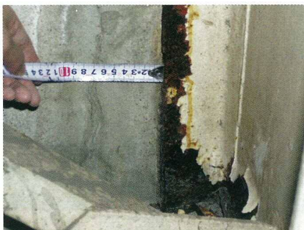
↑ 中程度のさびの例（腐食度 0.5 程度）
