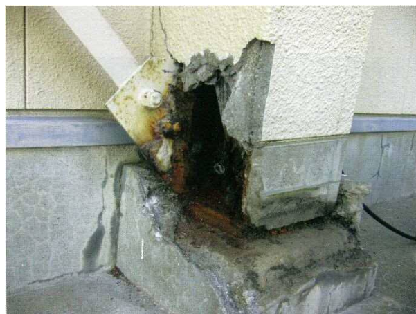
↑ 重度のさびの例（腐食度 0.0 程度）
