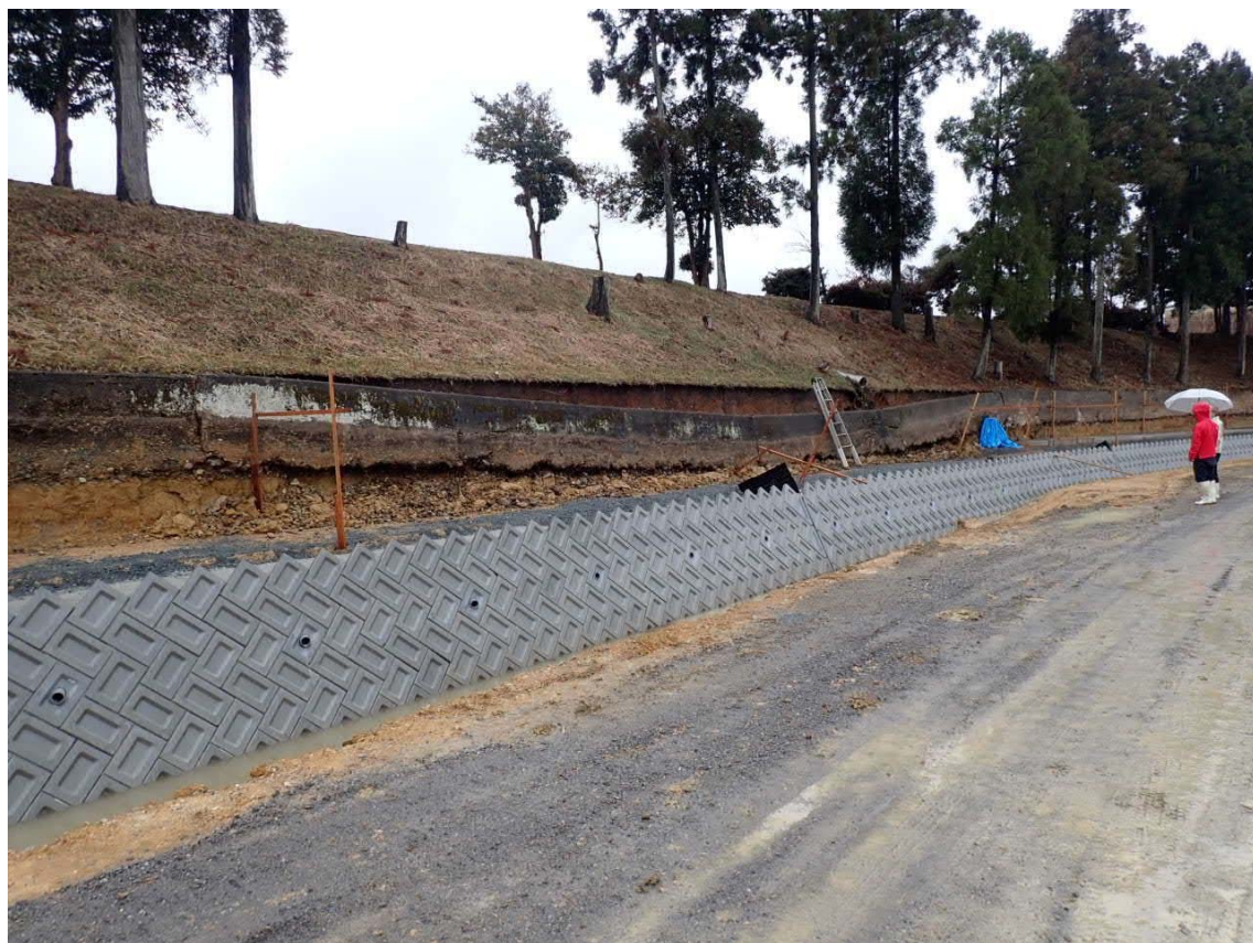
既存擁壁崩壊写真（北から）
