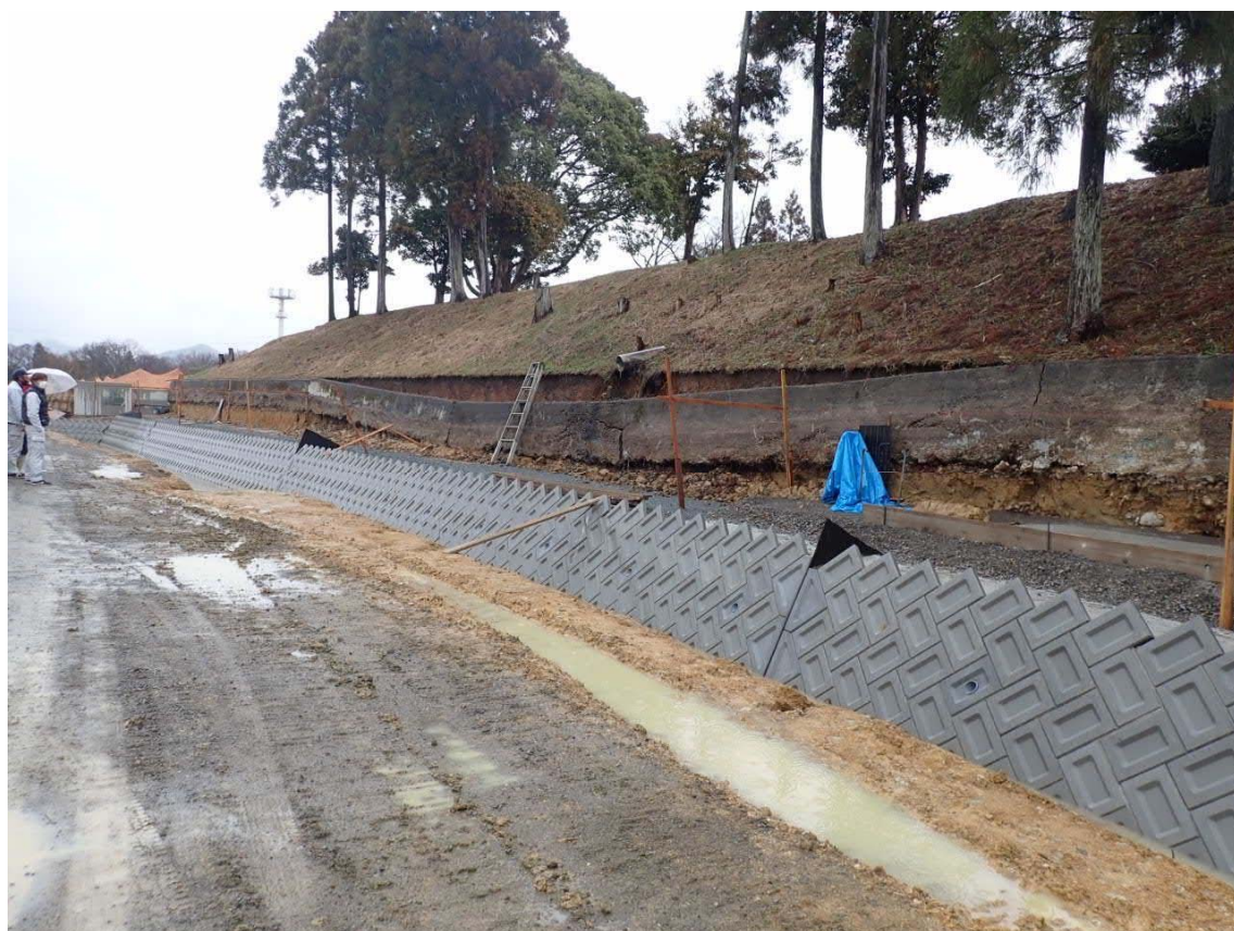
既存擁壁崩壊写真（南から）
