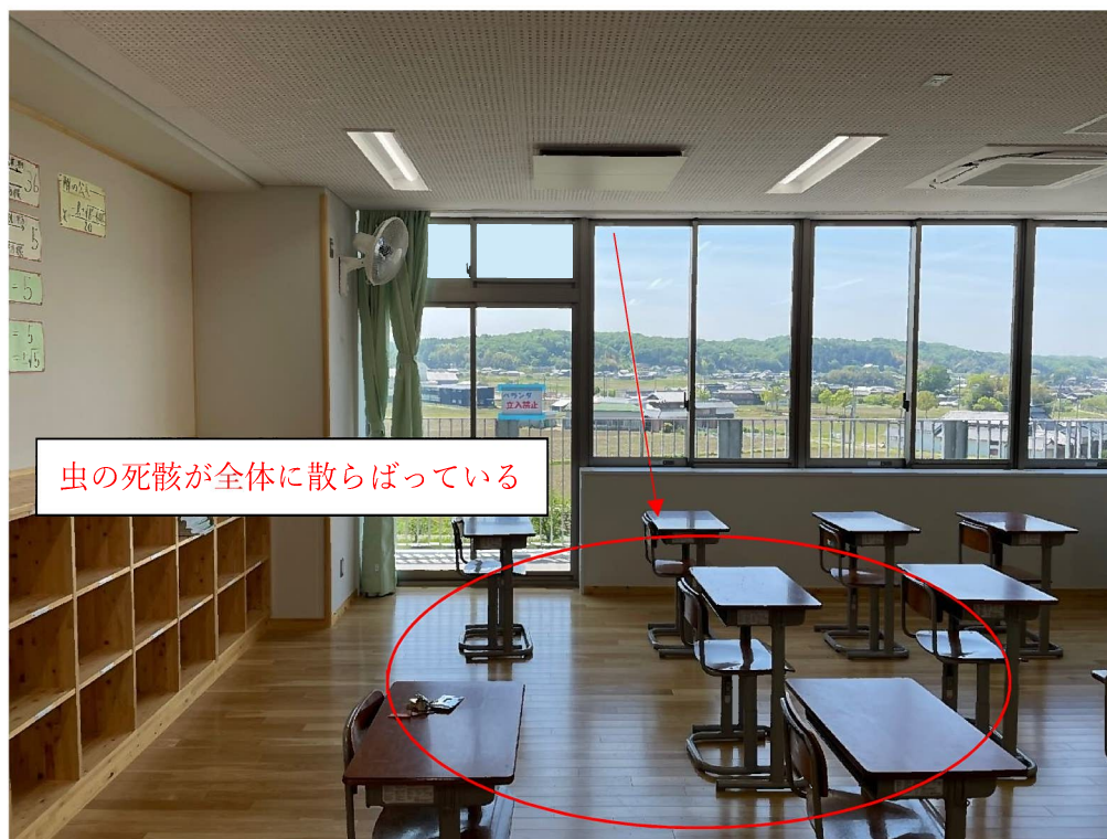
4階 多目的教室（402） 虫侵入防止ユニット設置なし
