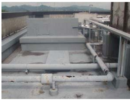
②：高架水槽周辺の配管
