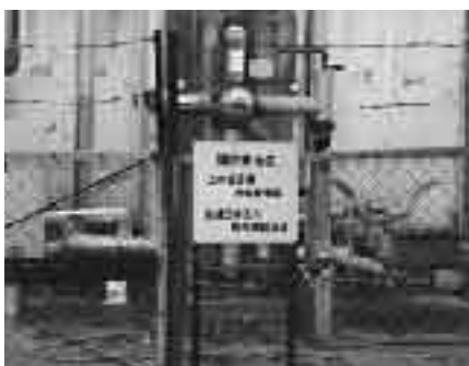
嬉野東地区の上水道設備
