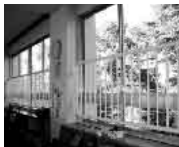
学校の転落防止柵
