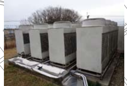
空調設備（室外機）
