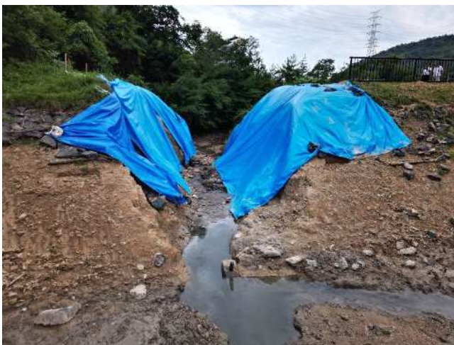
崩土カット後上流
