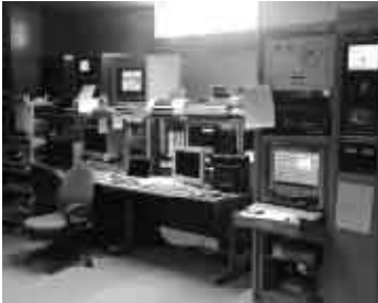
ケーブルテレビのセンター設備
