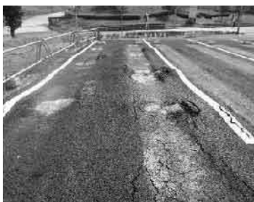
駐車場の損傷現況
