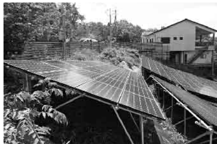
太陽光パネル
