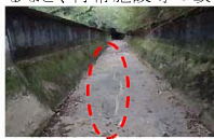
底版縦断方向ひび割れ
