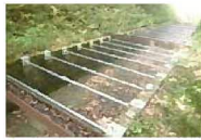
船木池洪水吐急流水路の転倒
