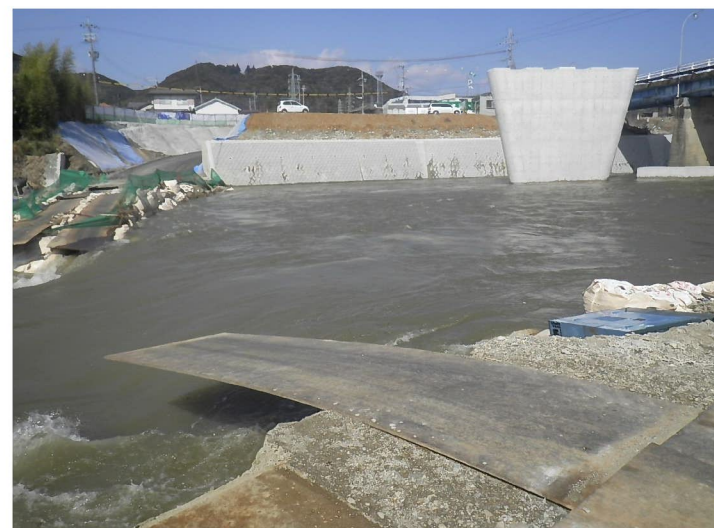
被災状況写真（左岸 新町側から撮影）
