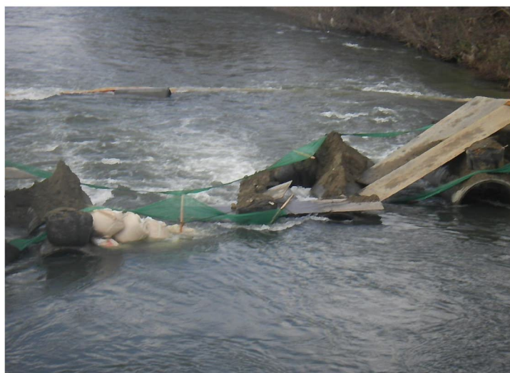
被災状況写真（滝見橋から撮影）
