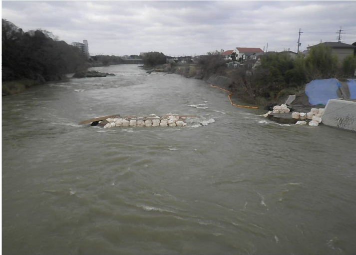
被災状況写真（滝見橋から撮影）
