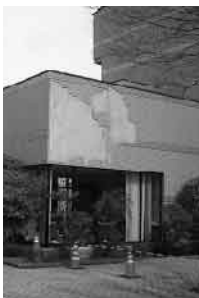
外壁のはく離が目立つ コスミックホール
