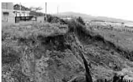
南山配水池法面崩壊現場
