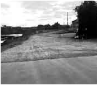
舗装の流出した座の浜
