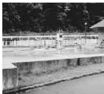
公共下水道処理施設「せせらぎ東条」
