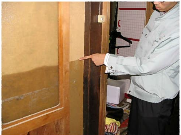
住宅浸水被害
