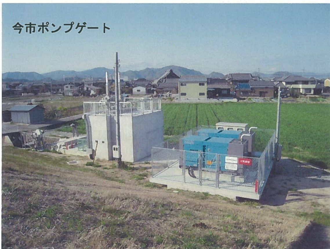
東用ポンプゲート
