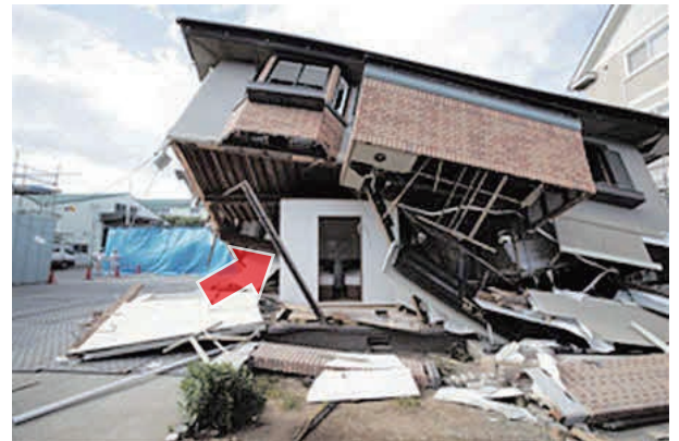
家屋崩壊から身を守る耐震シェルター(写真提供:都市政策課)
