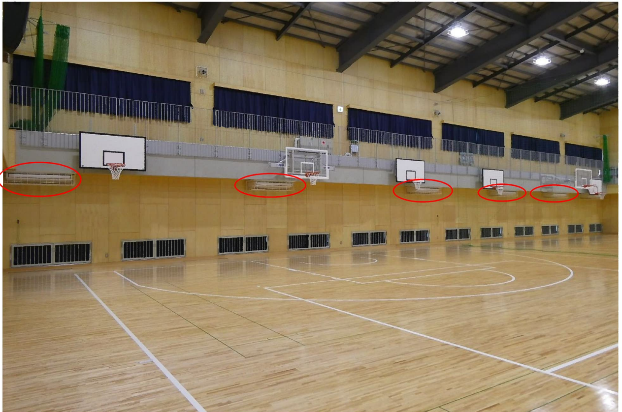
【完成】大体育館エアコン（令和6年12月26日撮影）
