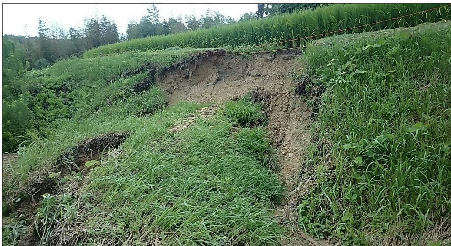
被災箇所④
