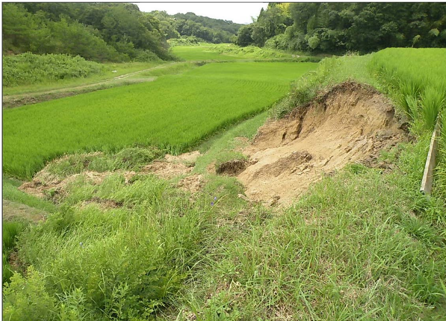
被災箇所③
