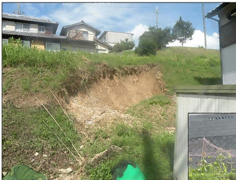
被災箇所 ①
