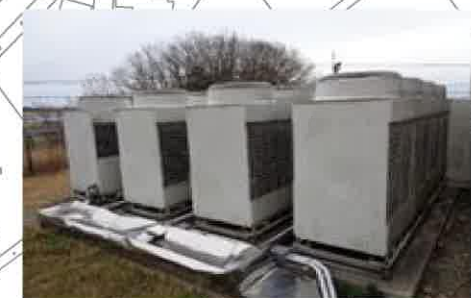
空調設備（室外機）
