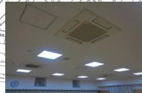
空調設備・照明設備
