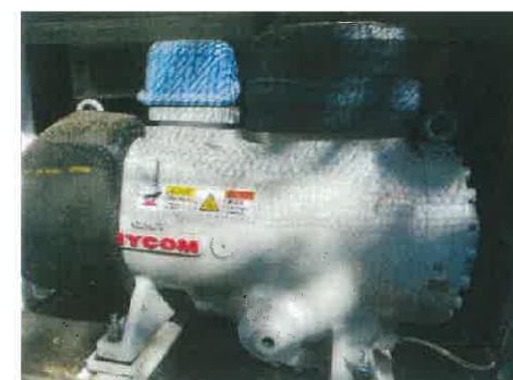
エコキュート圧縮機交換 (圧縮機破損によるガス抜け)
