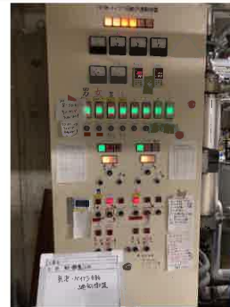
CP-2 気泡バイパスろ過制御盤 撤去更新
