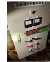
CP-6 源泉減水対策制御盤 撤去のみ
